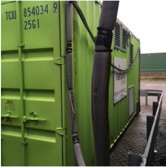
Container t.b.v. scrubber
