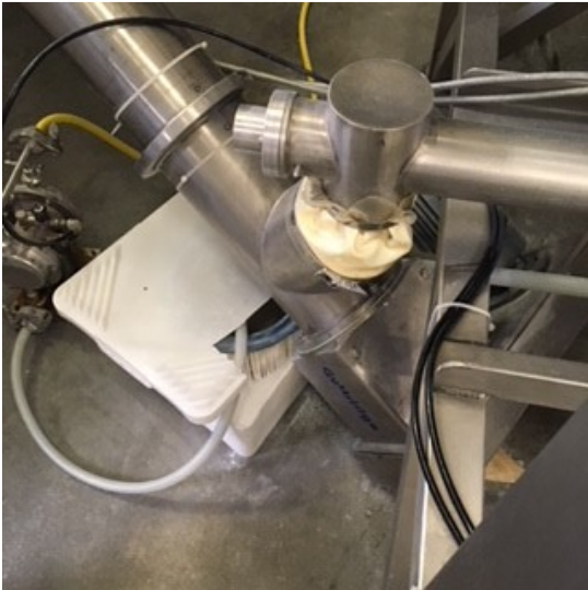
Transport uitgelekt product, filter lekwater
