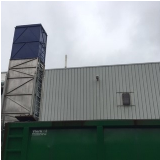
Oude ventilatie afvoerpijp, unit 2
