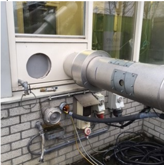
Aanvoer afgassen naar scrubber
